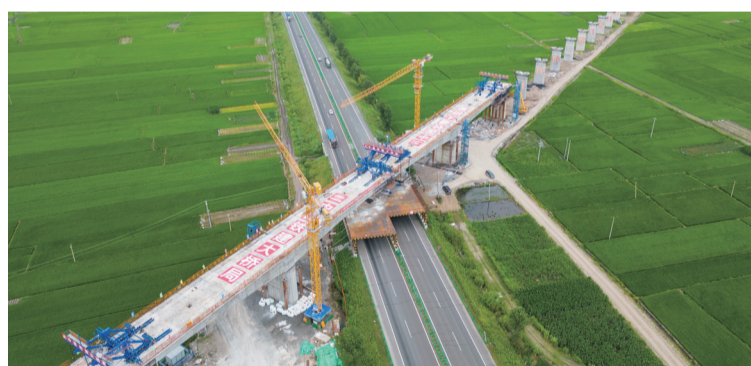
7月26日,位于黑龙江省庆安县的哈伊高铁哈尔滨至铁力段首个特大桥悬浇连续梁完成合龙,标志着我国最北端在建高铁桥梁建设进入新阶段。
