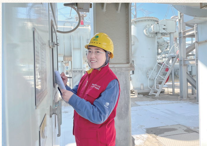
吴嘉楠巡视检查电气设备。通讯员 王梅琦 摄
