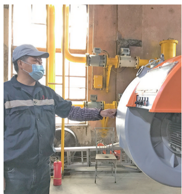
山川小区工作人员检查锅炉主机运行情况。西海全媒体记者 芦舜 摄
