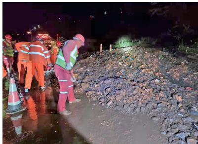
西宁南养护大队工作人员连夜清理泥石流。
