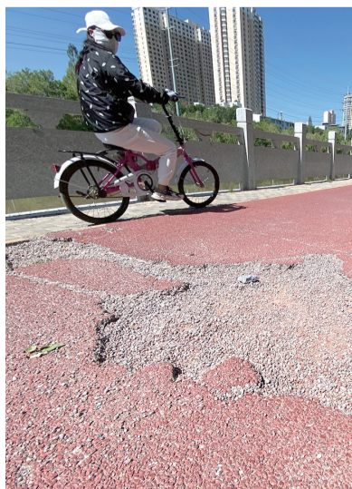
自行车道坑坑洼洼。
