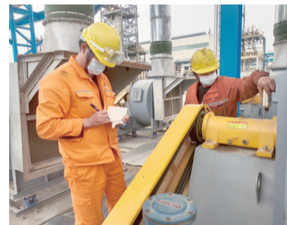
生产车间里,工作人员检查设备。西海全媒体记者 范程程 通讯员 石杰 摄
