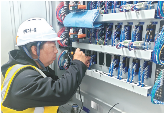
图为“格桑花”工班成员郑艳正在信号机械室排查信号线路
