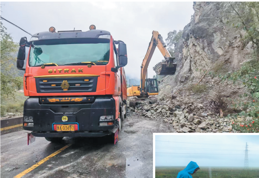
↑山体塌方应急救援现场。
