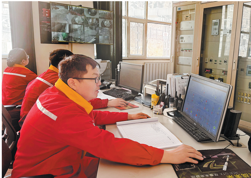
宝库河一级电站中控室工作日常。
