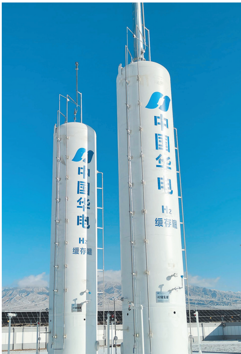
华电德令哈3兆瓦光伏制氢项目。中国华电集团有限公司青海分公司供图
