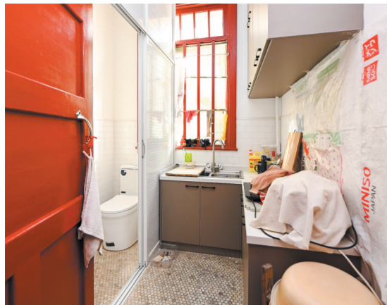
左侧是上海市杨浦区长海路街道居民家中安装的抽水马桶(10月29日摄)。新华社记者 陈浩明 摄
