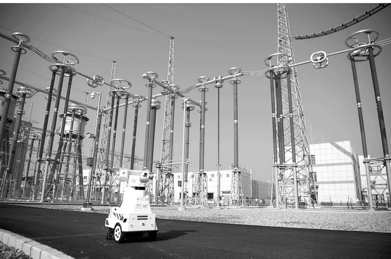
在青海—河南±800千伏特高压直流工程豫南换流变电站内，基于5G网络的“慧眼”全方位监视着站区。针对特高压变电站规模大、设备种类多的特点，该电站于今年5月实现5G网络站内全覆盖，配置适用5G网络的巡检机器人、无人机及高清视频监控设备，提升巡检监视设备的感知能力，确保特高压工程安全平稳运行。图为巡检机器人在变电站内巡检。
