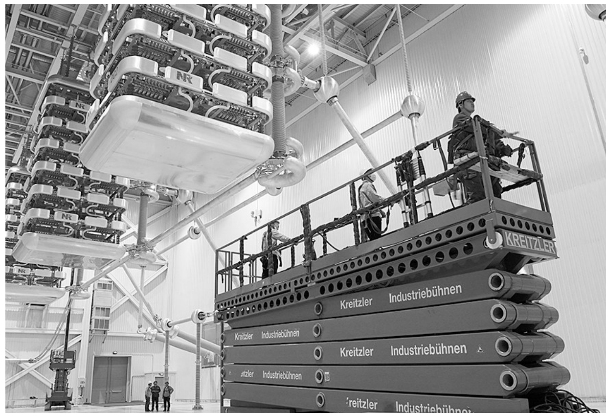
7月9日,在青海—河南±800千伏特高压直流工程青南换流站内,工作人员正在对双极低端换流阀设备进行调试消缺。该工程的建成,将有效提高青海乃至西北地区清洁能源的整体外送消纳水平,对于保障国家能源安全、推动清洁发展、拉动经济增长,打赢脱贫攻坚战和蓝天保卫战具有重大意义。 王国栋 摄
