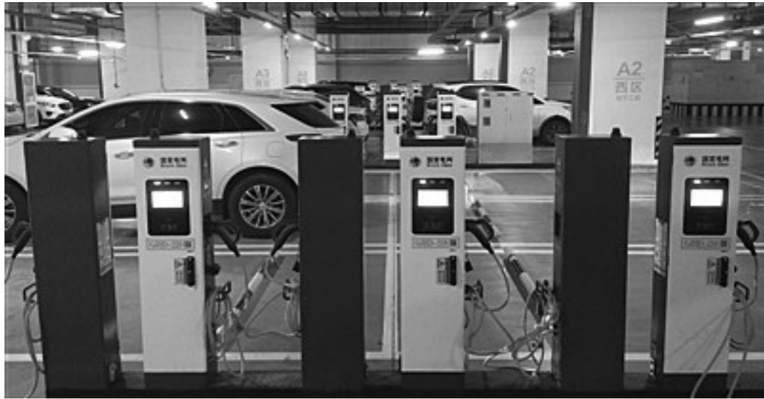
图为五棵松体育中心地下停车场的电动汽车充电站。 周维海/摄
