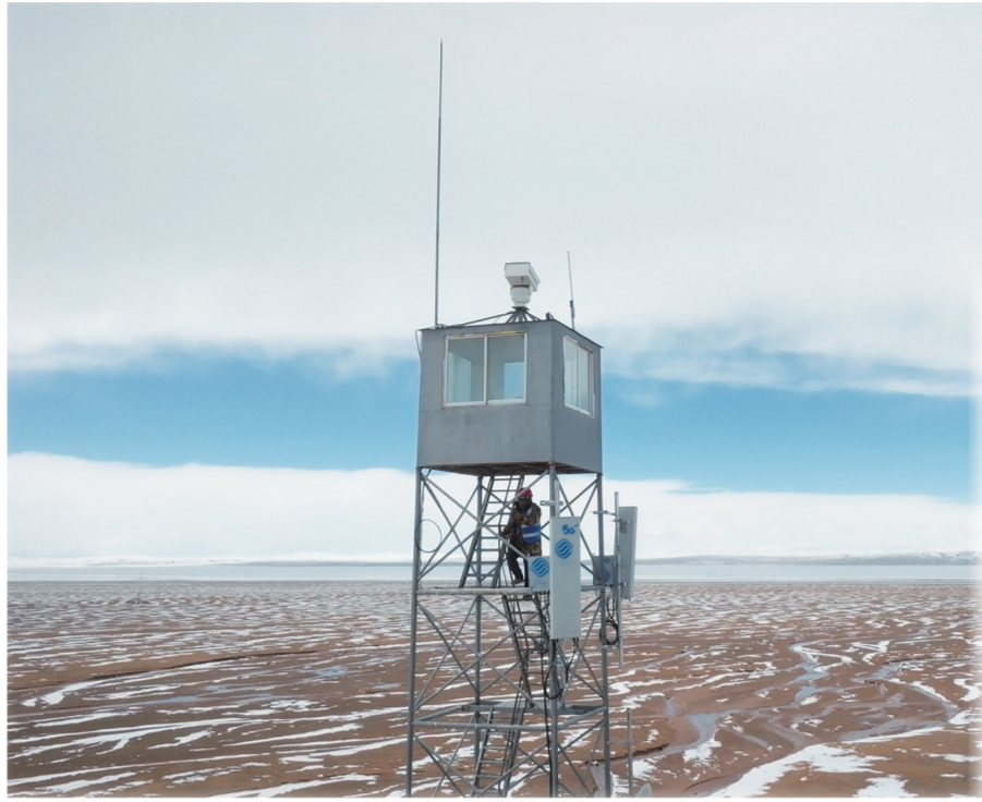
青海铁塔公司协同青海移动公司开通可可西里卓乃湖基站。
