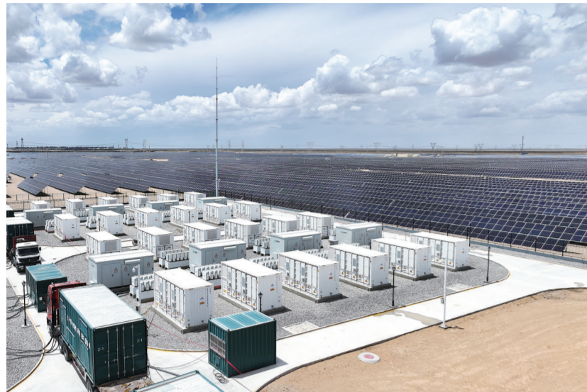
青海格尔木鲁能构网型储能电站。
