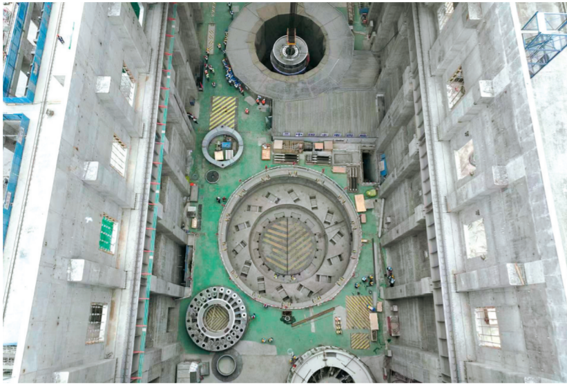
羊曲水电站首台机组转轮顺利吊装成功。 通讯员 樊国栋 摄
