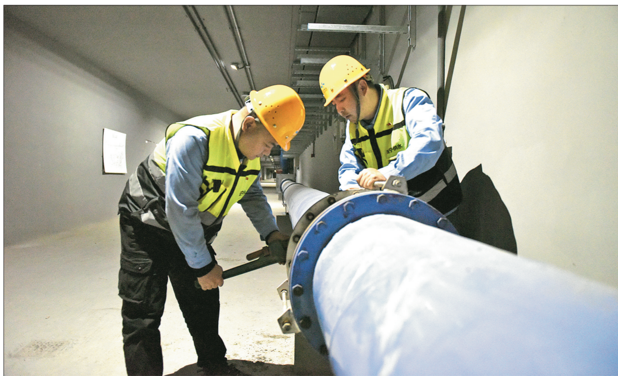
西宁市综合管廊建设利用西高东低川谷型城市特点，实现了给水、雨污水、燃气、电力、通信、供热等管线全部入廊，是国内管线入廊最全面的城市综合管廊，管廊的建成有效解决城市“马路拉链”“空中蜘蛛网”、路上看海等现象，提升城市形象和居民生活幸福指数。图为西宁市供水集团对管廊内泵房、水质等重点区域进行日常巡检排查。
