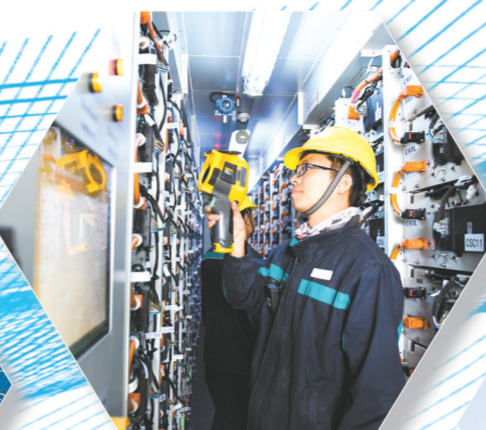
鲁能新能源(集团)有限公司储能电站巡检中。
