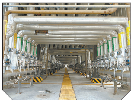
蓝科锂业2万吨装置管廊。
