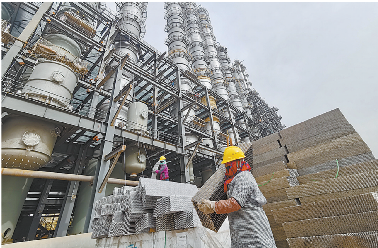
电子级多晶硅项目的顺利投产,为青海经济助力。
