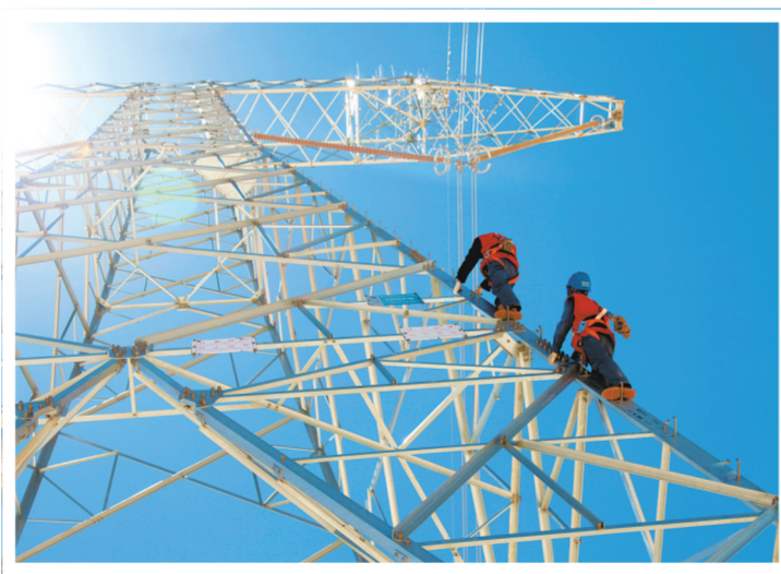
国网青海检修公司输电作业专业人员在±400千伏柴拉直流输电线路登塔消缺。 汪大鹏 摄
