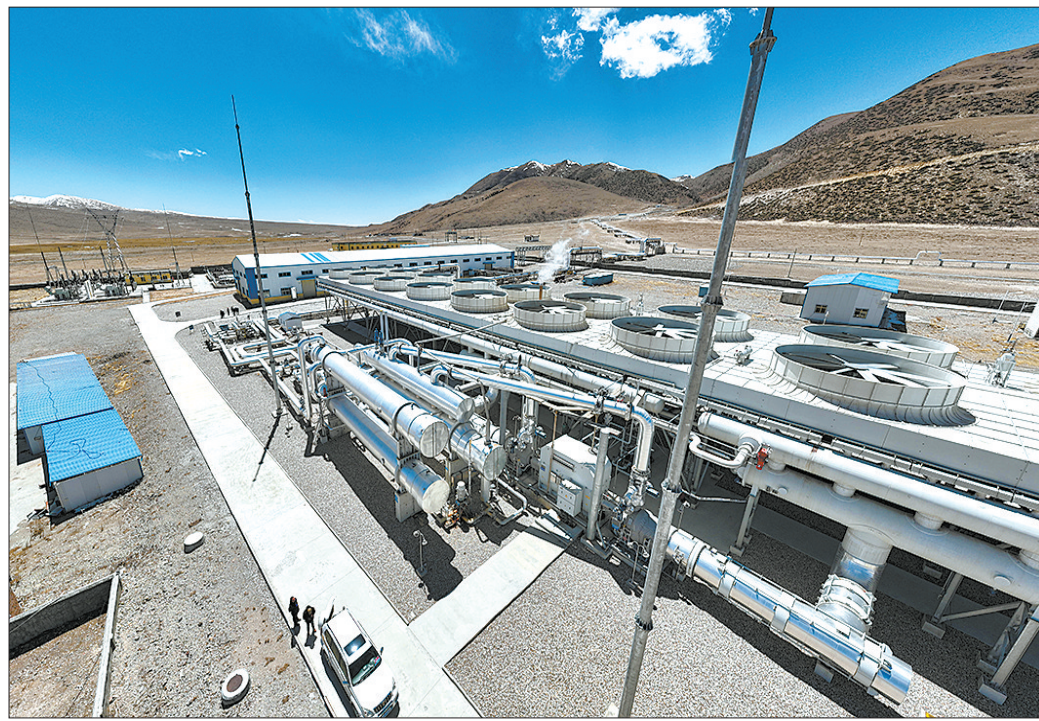
羊易地热电站(4月6日摄，无人机照片)。
