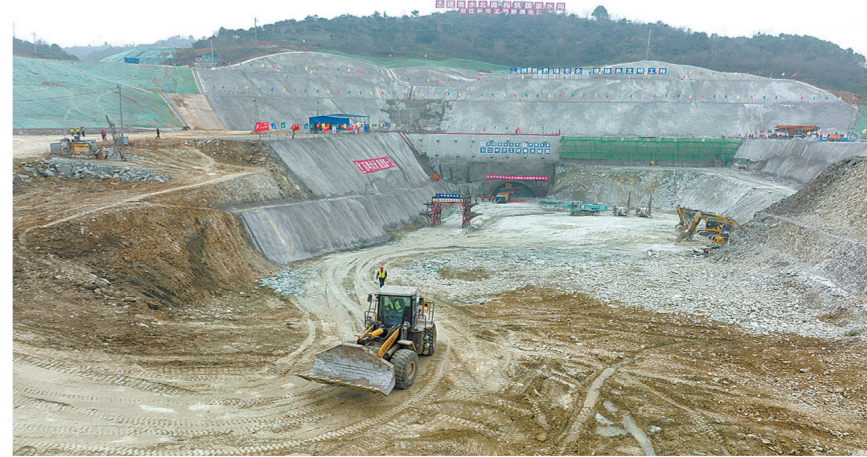
2月18日拍摄的引江补汉工程主体隧洞施工现场(无人机照片)。
