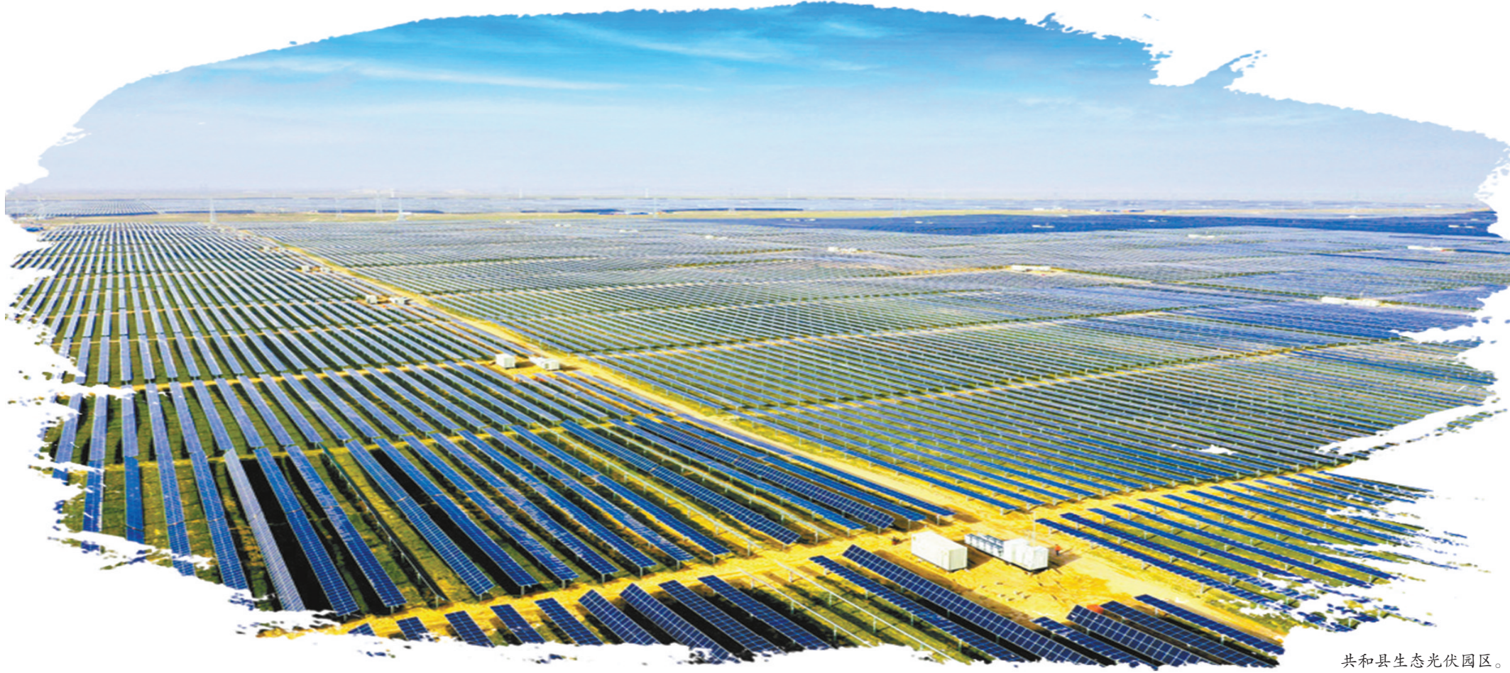
共和县生态光伏园区。
