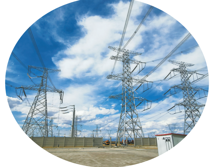
青豫直流750千伏换流站输电线路。
