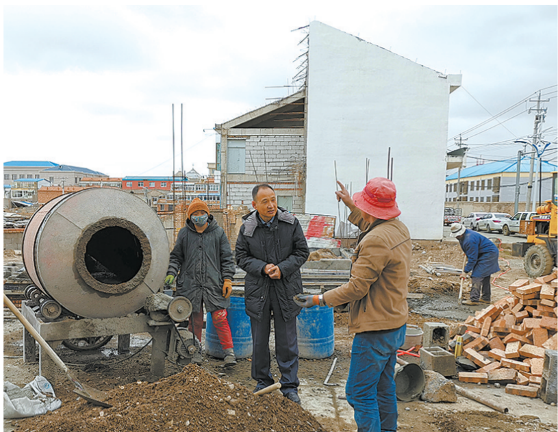
赵树明(左二)在河南县公共旱厕示范工程现场。 本人供图
