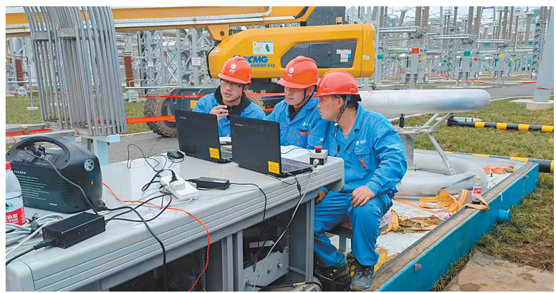
±800千伏布拖换流站500千伏GIL设备现场振荡雷电冲击试验现场。何炳勋 摄
