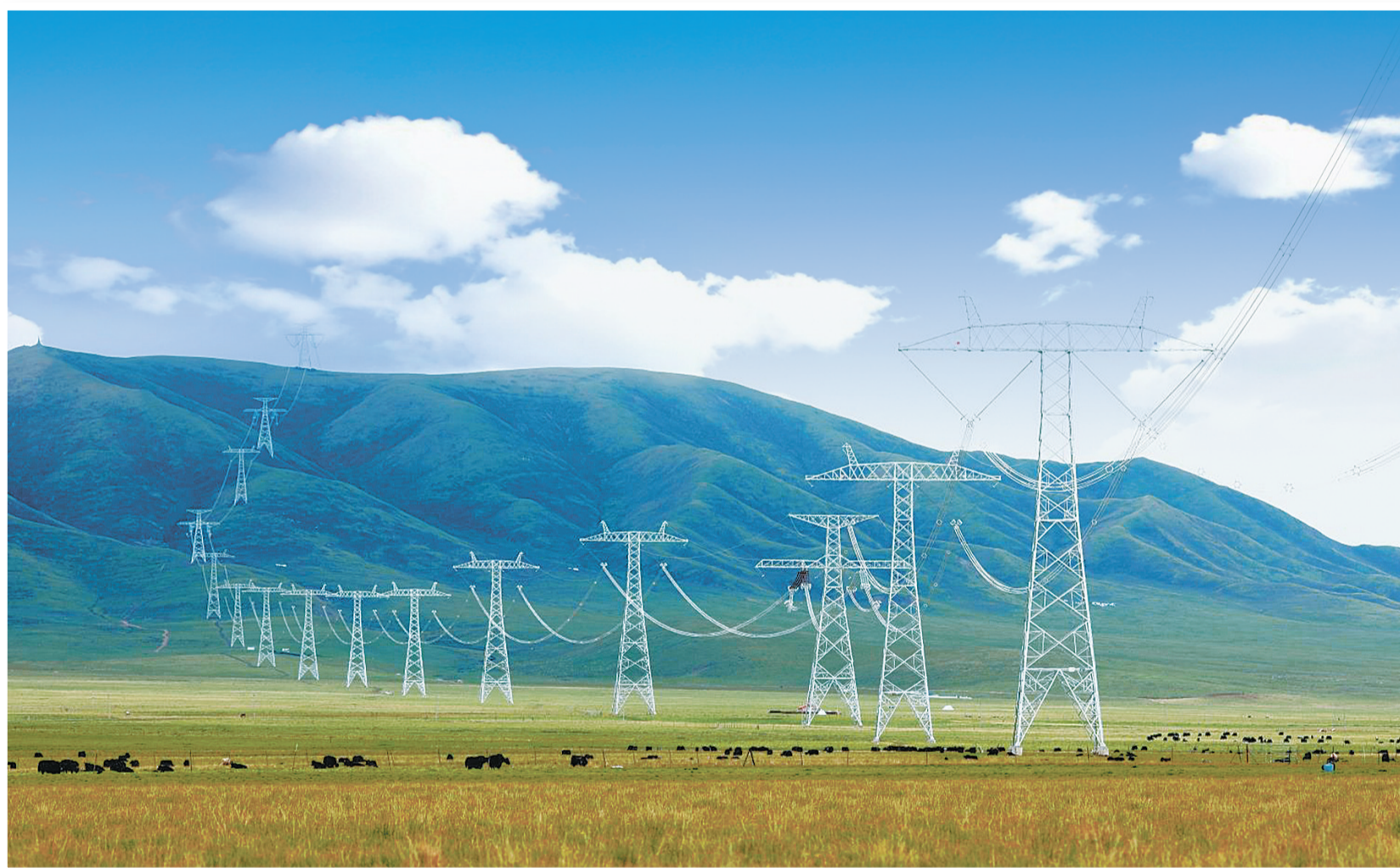
±800千伏青豫特高压直流输电线路跨越山川草原将“绿电”送往华中地区。
