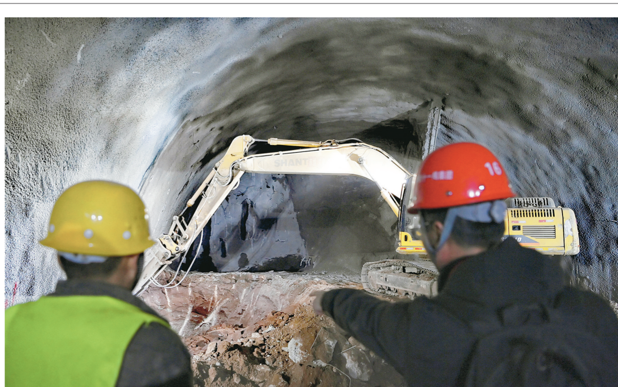
2月19日，春节假期后，中铁十一局负责施工的我省“十四五”规划重点交通建设项目G109小峡口(王家庄至昆仑路段)改建工程大南山隧道工程复工建设。 本报记者 祁国彪 摄
