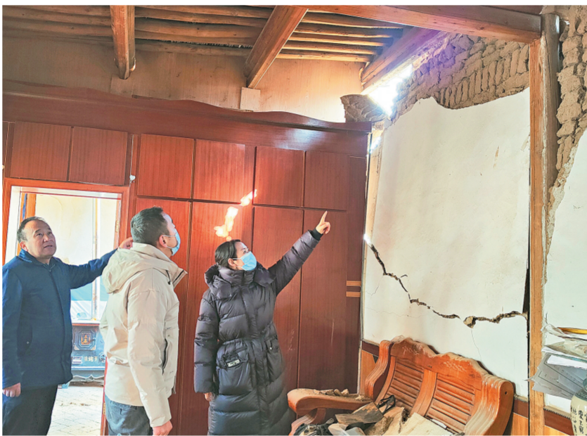
登记房屋受损情况。
